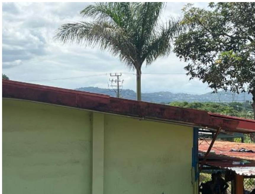
Fotos. Paredes deterioradas en módulos.
